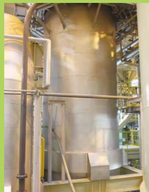
■排ガス温度調節器 ボイラを通ってきた排ガスの温度を急速に冷却し、ダイオキシン類の再合成を抑制します。
