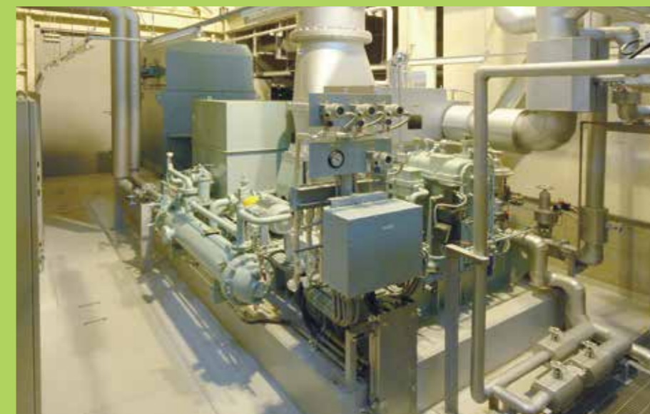
■蒸気タービン発電機 ボイラで作られた蒸気を利用して発電し、施設内の電力を賄うとともに余剰電力については施設外に売電します。
