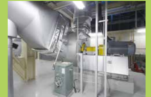
■誘引通風機 ろ過式集じん器後段に位置し、排ガスは、この機械の吸引力により最終的に煙突から大気に排出されます。
