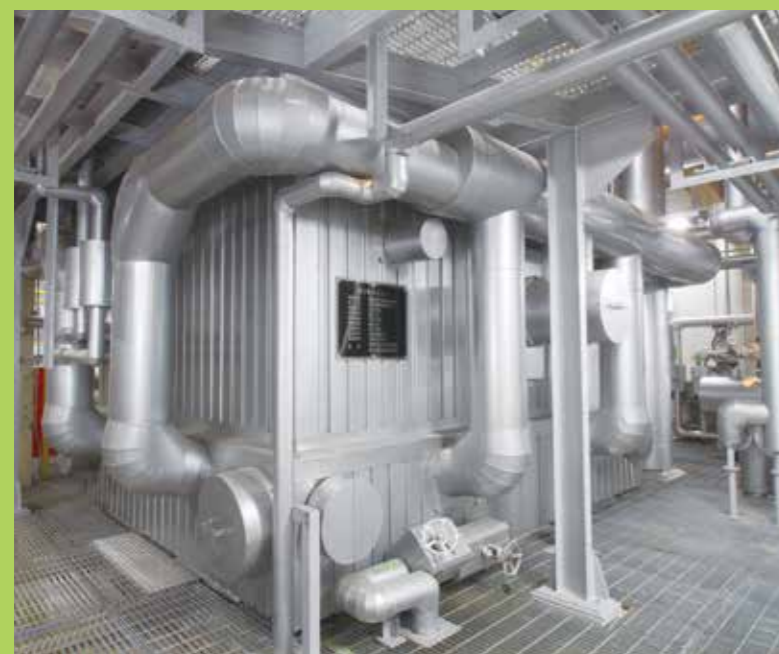
■ボイラ 燃焼室から送られた排ガスを利用して蒸気を作り、施設内の発電や温水等に利用します。
