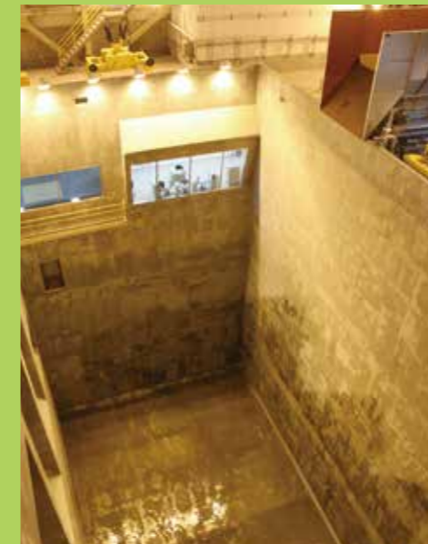
■ごみピット ごみは一旦ごみピットに貯留され、ごみクレーンにより攪拌処理等をした後で、溶融炉上部に投入します。
