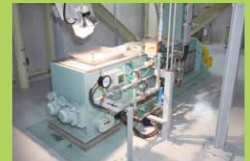
■混練機 ろ過式集じん器で捕集されたばいじんに重金属安定化剤を添加し、混練処理し、重金属類を安定化させます。
