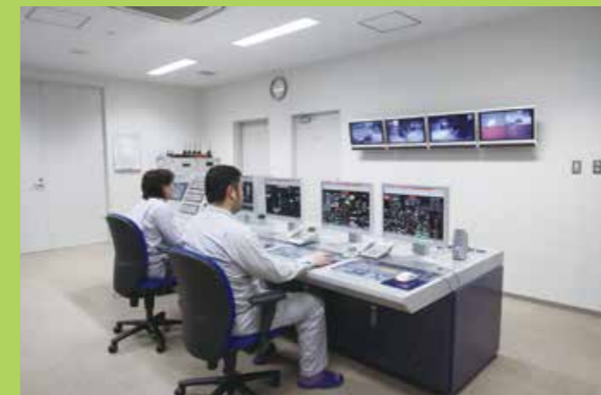
■中央操作室 コンピュータで、全設備の運転を24時間管理しています。運転データや各機器の状況を適切に把握し、安全に運転するための設備です。
